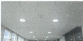
감지기 설치 (양호)
